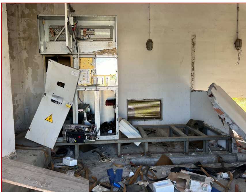
Figura 14 - Interni Centrale Elettrica
