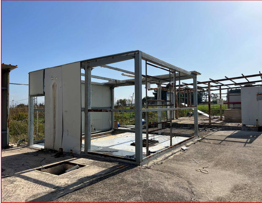
Figura 15 – Locali Centrale Idrica
