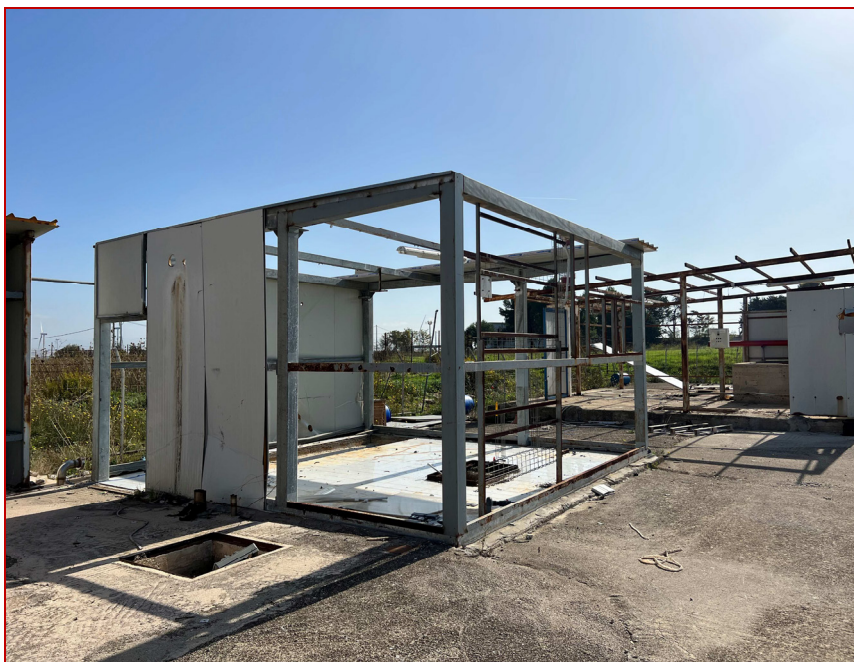
Figura 15 – Locali Centrale Idrica
