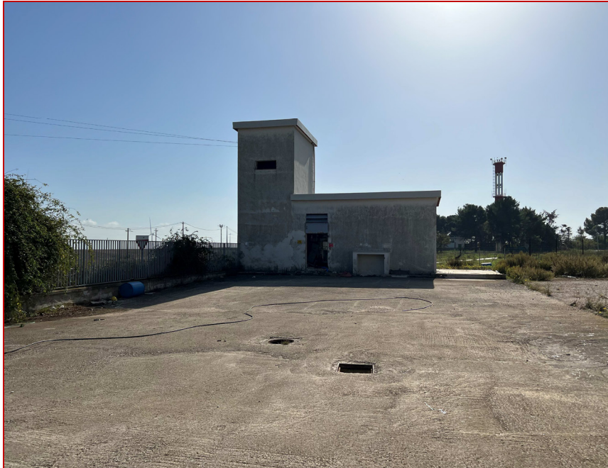
Figura 13 - Locali Centrale Elettrica
