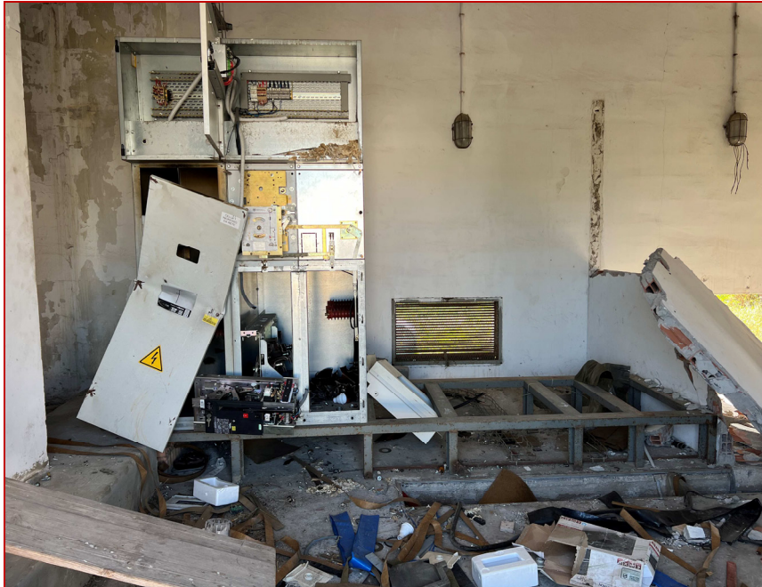
Figura 14 - Interni Centrale Elettrica
