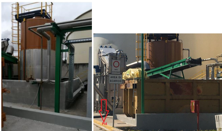
Figura 6 – Serbatoi per deposito preliminare rifiuti pericolosi ed individuazione Pi4
