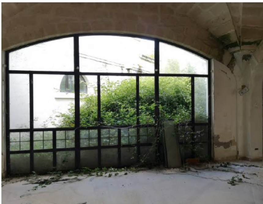
Arbusti che si introducono negli ambienti interni attraverso le vetrate rotte
