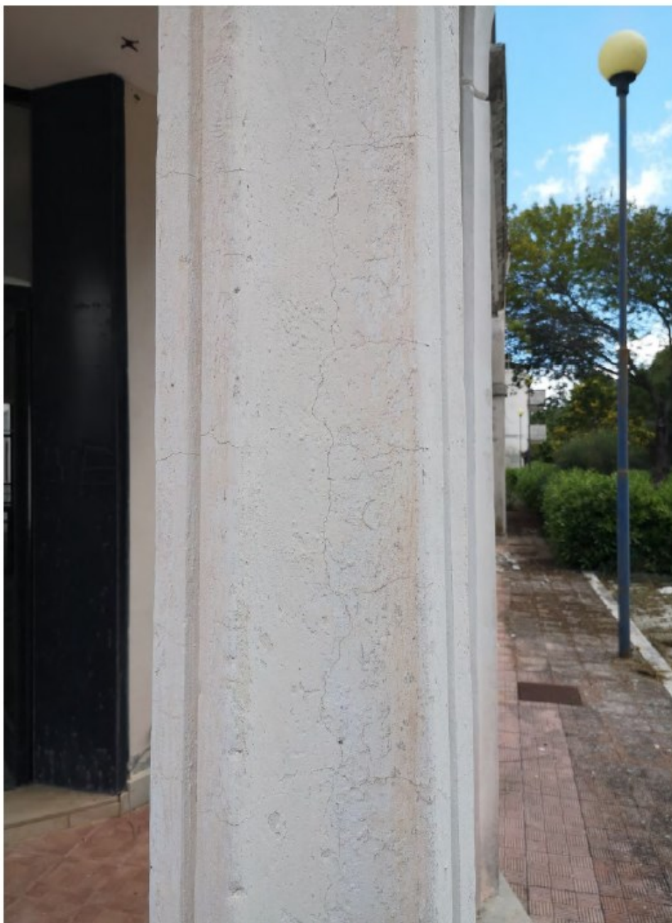
Quadri fessurativi dei rilievi in c.a. dei prospetti
