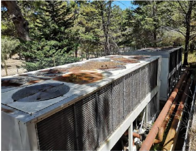
Unità esterne dell'impianto di trattamento aria
