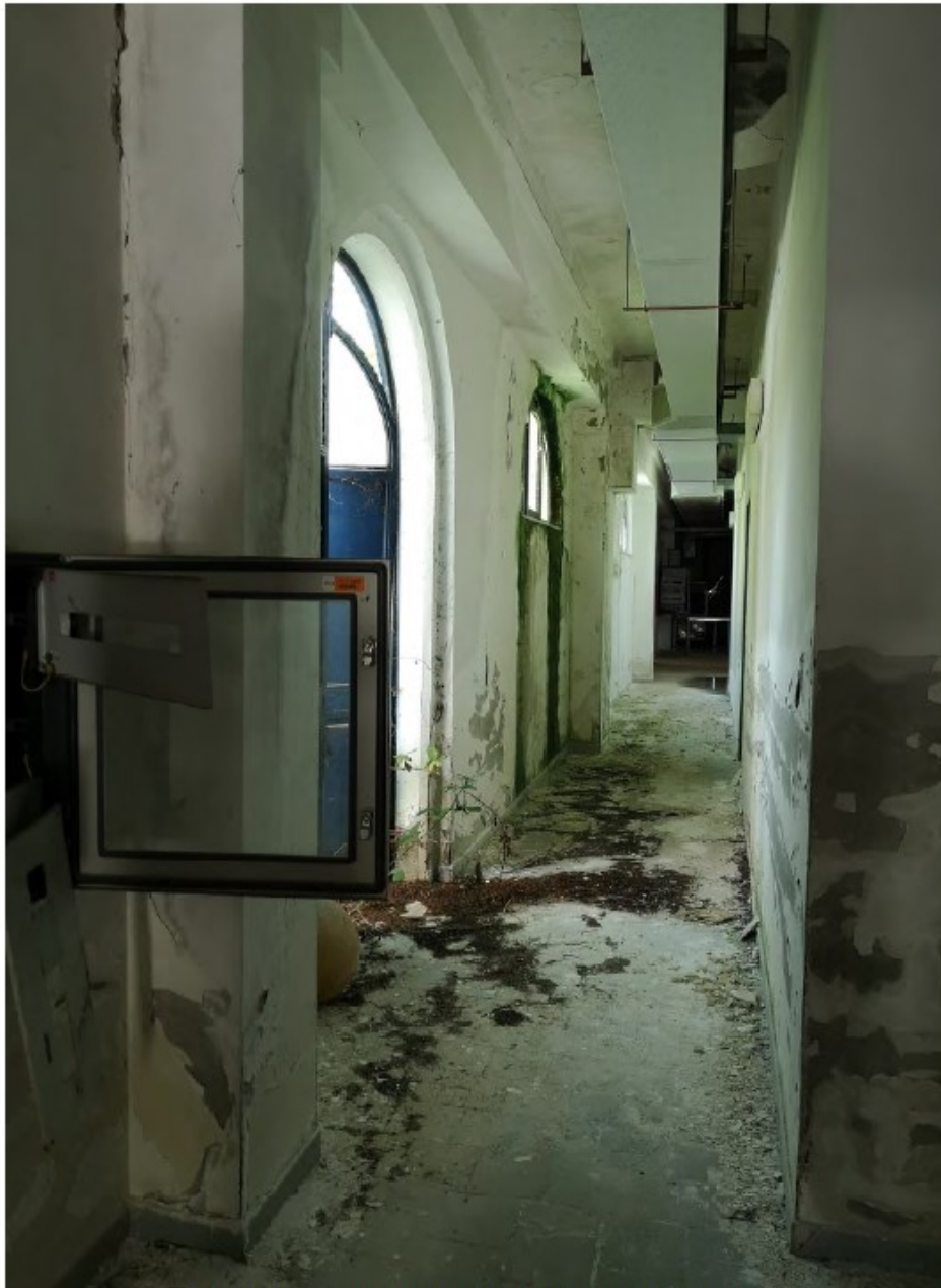
Corridoi perimetrali vandalizzati e deteriorati per infiltrazioni
