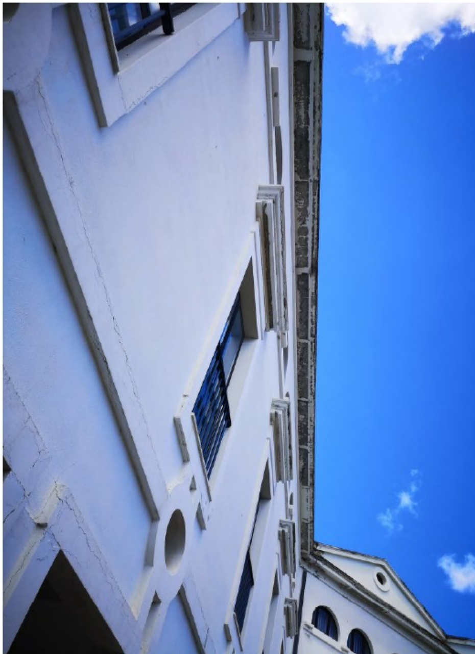
Diffusi quadri fessurativi dei decori in c.a. dei prospetti
