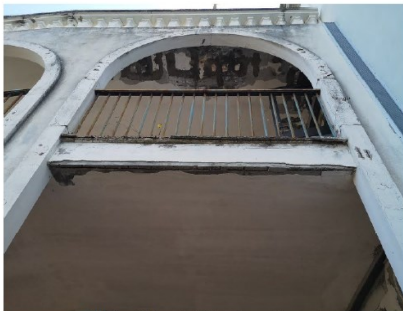
Diffusi quadri fessurativi dei decori in c.a. dei prospetti
