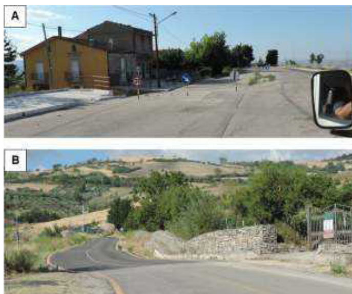
Figura 2-14. Interferenze di infrastrutture stradali con fenomeni franosi di recente attività, che ne hanno limitato la funzionalità, rendendo necessari interventi di perimetrazione (segnaletica in figura A) o sistemazione (recente asfaltatura in figura B).
