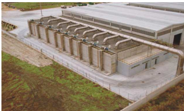
Figura 8: Laterale dell'edificio di biostabilizzazione con particolare delle condotte aria di 9 dei biotunnel esistenti.
