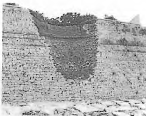
Foto 6 - Cedimento del muro sull'UF3
