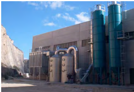
Trattamento aeriformi impianto inertizzazione rifiuti
