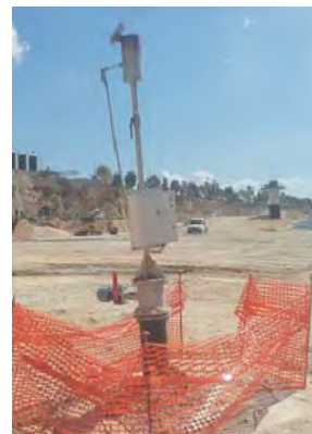
Impianto recupero energetico biogas (a sx) e torcia statica testa pozzo (a dx)
