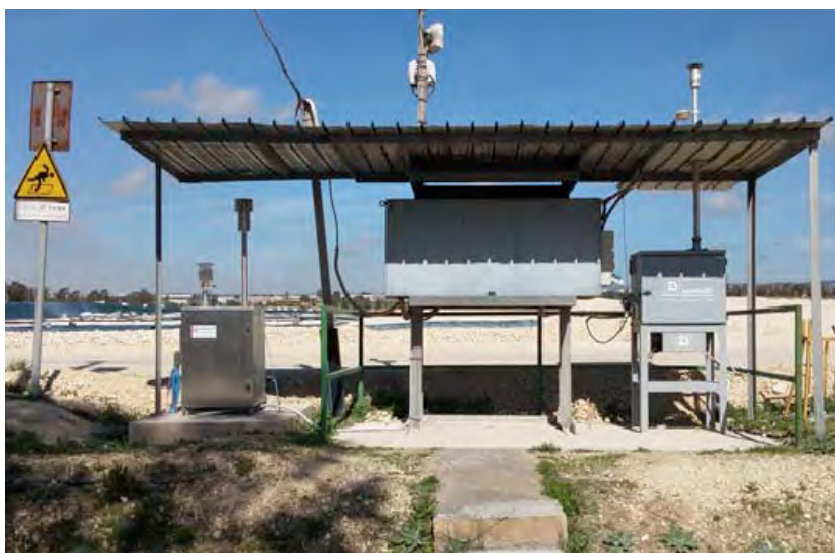
Centralina di monitoraggio aria n°2
