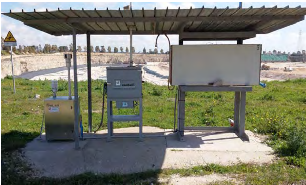
Centralina di monitoraggio aria n°3
